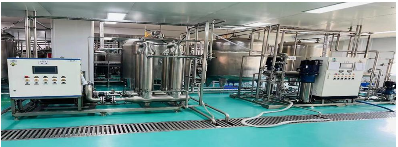
图3 精制车间设备
